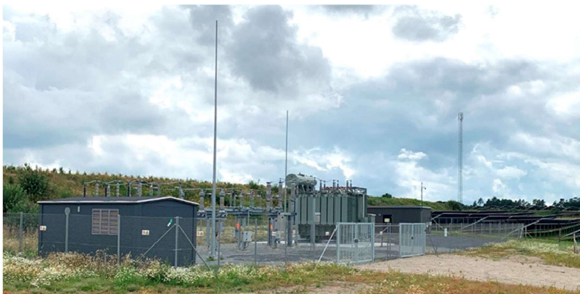
Eksempel på 60 kV step-up transformer. Step-up transformeren placeres inden for en transformerstation, der er særskilt indhegnet. De to høje master inden for indhegningen er lynafledere. Kilde: Unison Energy Partners
