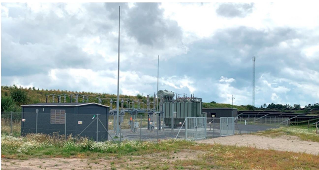
Eksempel på 60 kV transformerstation med step-up transformer. De to høje master inden for indhegningen er lynafledere. Kilde: Unison Energy Partners
