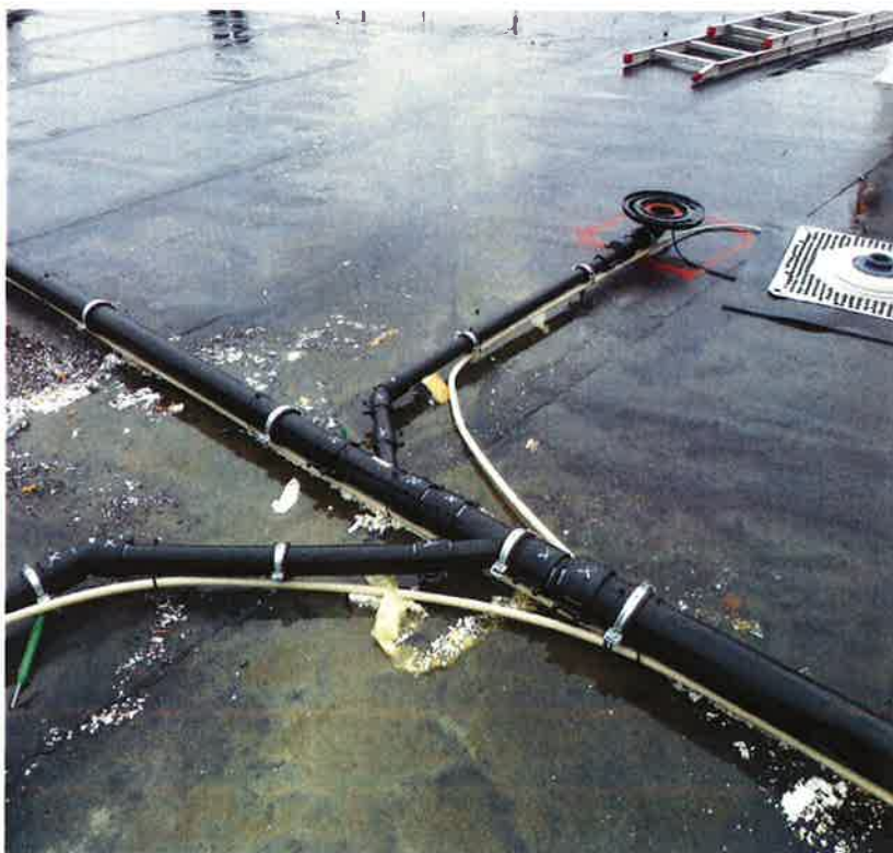
Figur 3. UV-system (tagafvandingsystem) indbygget i det varme tag medfører en betydelig risiko for beskadigelse af rør ved den mekaniske fastgørelse af isolering og tagdækning. En bedre løsning er en rørføring under tagdækket.
