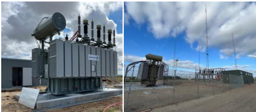
Figur 13. Billede af eksempel på 60 kV step up transformer tv og lynafledningsmaster th.
