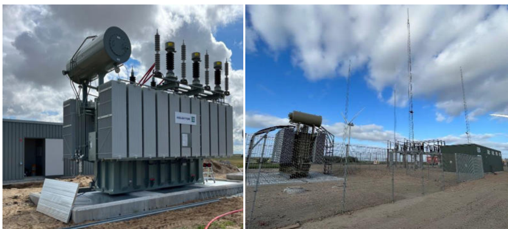
Figur 11. Billede af eksempel på 60 kV step up transformer tv og lynafledningsmaster th.
