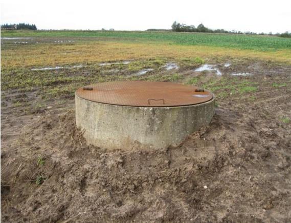
Foto udefra: Overbygning med låg
