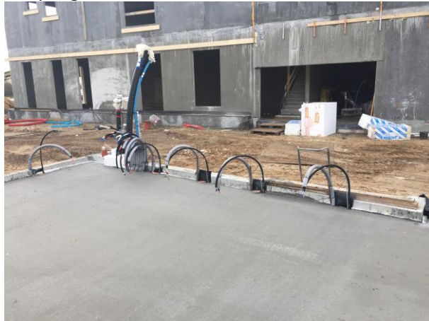
Afsætning og fastgørelse af forsyningsrør – OK
