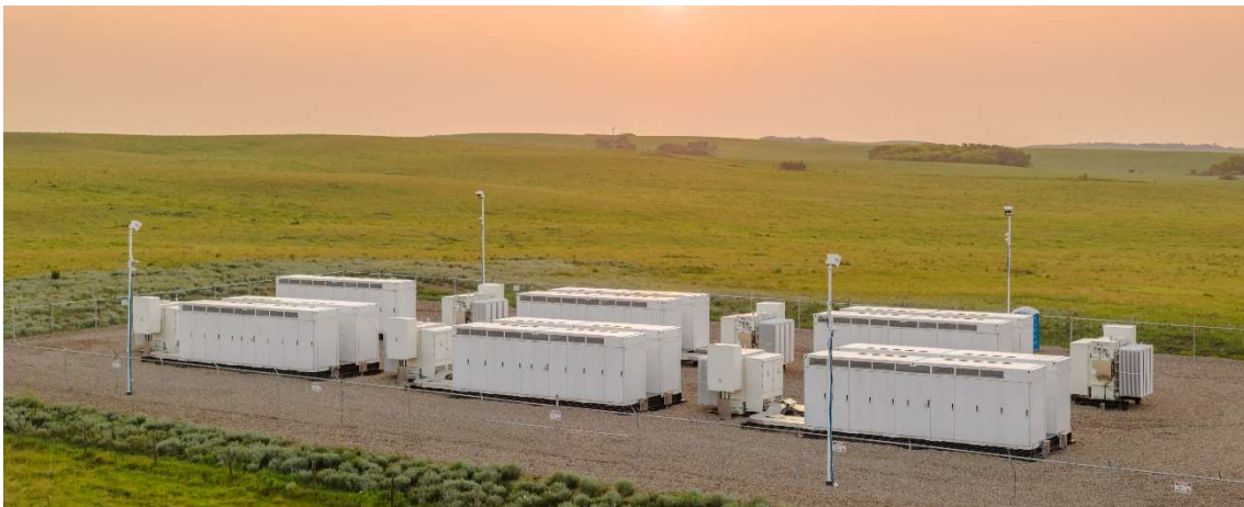
Eksempel på batterianlæg. Unison Energy Partners
