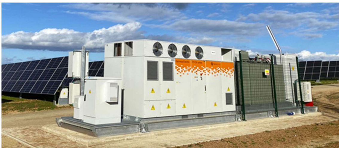
Eksempel på centralinverter med transformere. Kilde: Unison Energy Partners
