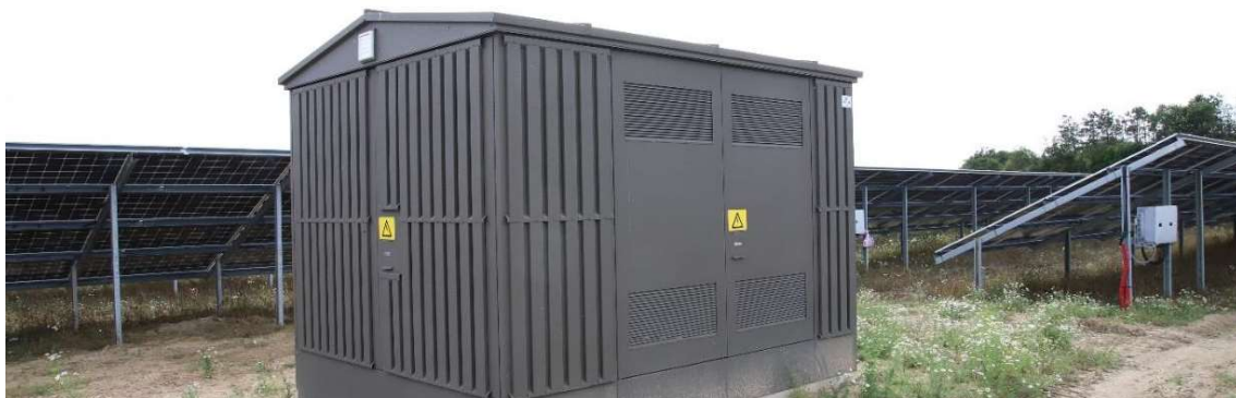
Eksempel på en fordelingstransformer. Den hvide boks til højre er en inverter. Kilde: Unison Energy Partners
