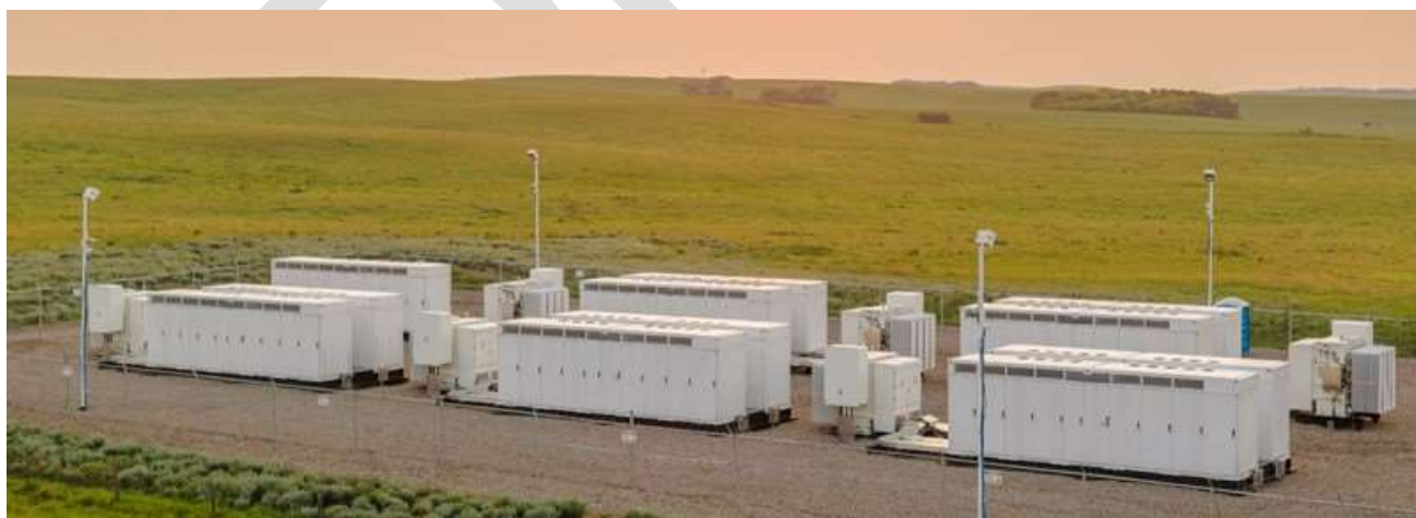
Billede 2.5: Eksempel på batterianlæg. Kilde: Unison Energy Partners
