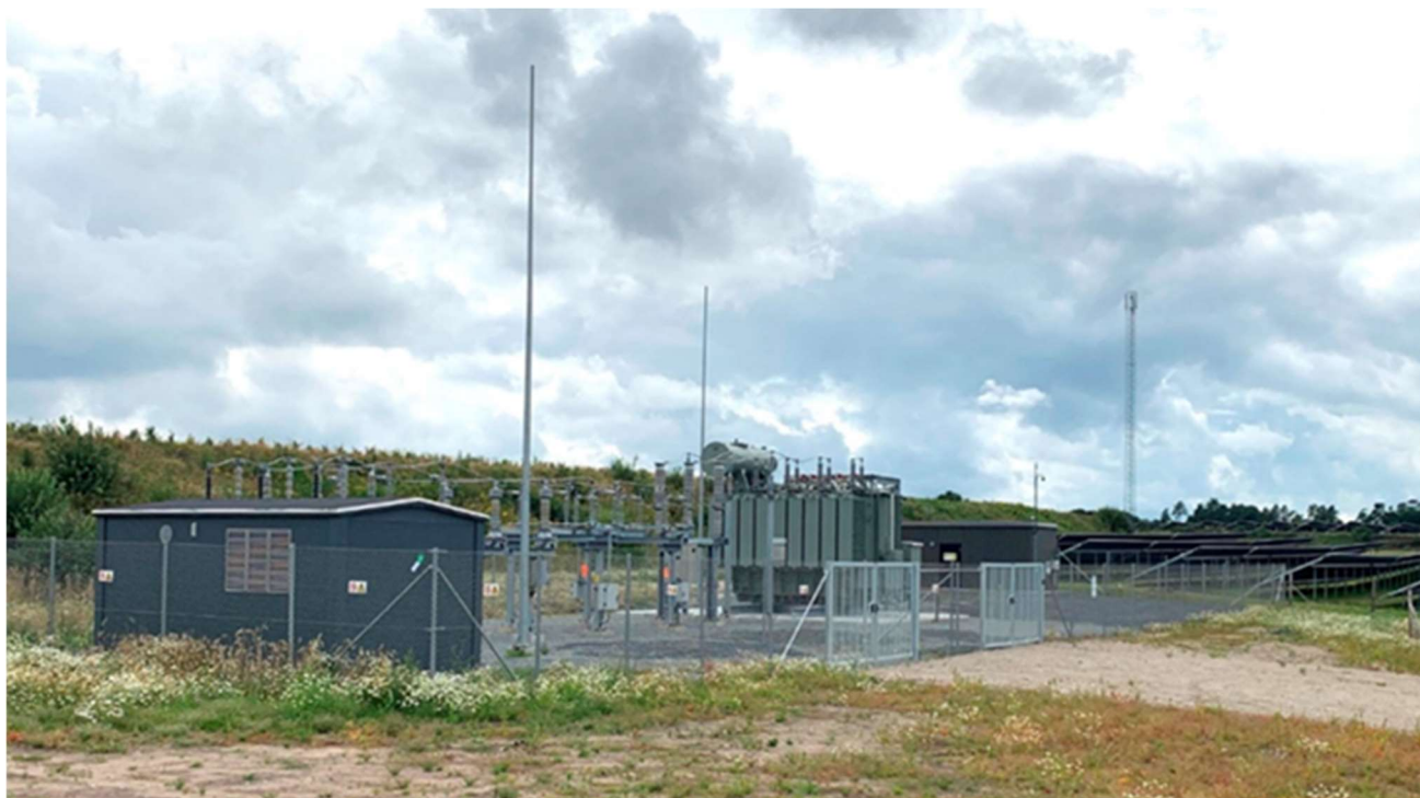
Billede 2.4: Eksempel på 60 kV transformerstation med step-up transformer. De to høje master inden for indhegningen er lynafledere. Kilde: Unison Energy Partners
