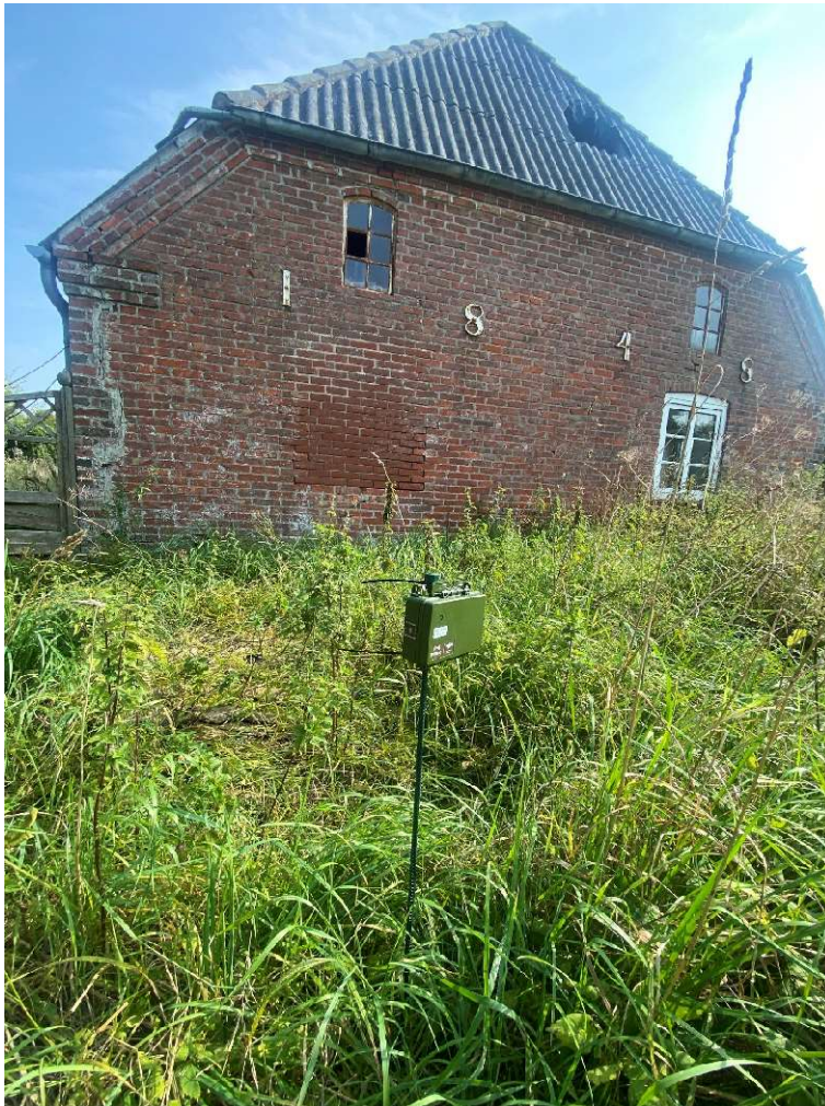
Figur 2. Bygning A set fra vest. Forest i billedet en lytteboks. Det stor hul i taget ses også på Figur 3.
