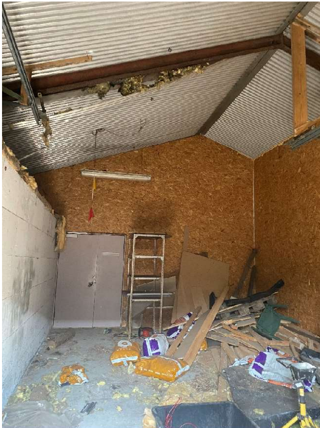
Figur 5. Bygning B indefra i den sydlige del, hvor man kan se et undertag med isolering.
