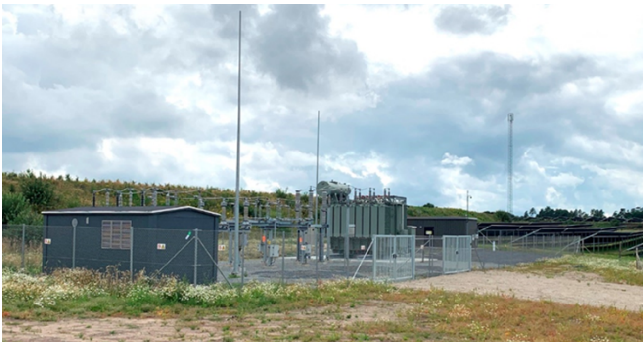
Eksempel på 60 kV transformerstation med step-up transformer. De to høje master inden for indhegningen er lynafledere. Kilde: Unison Energy Partners
