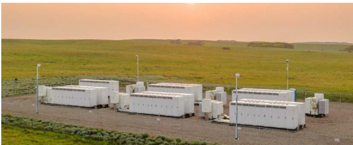
Eksempel på batterianlæg. Unison Energy Partners
