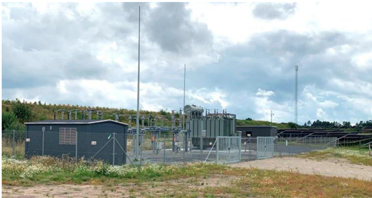
Billede 1-2: Eksempel på 60 kV transformerstation med step-up transformer. De to høje master inden for indhegningen er lynafledere. Kilde: Unison Energy Partners
