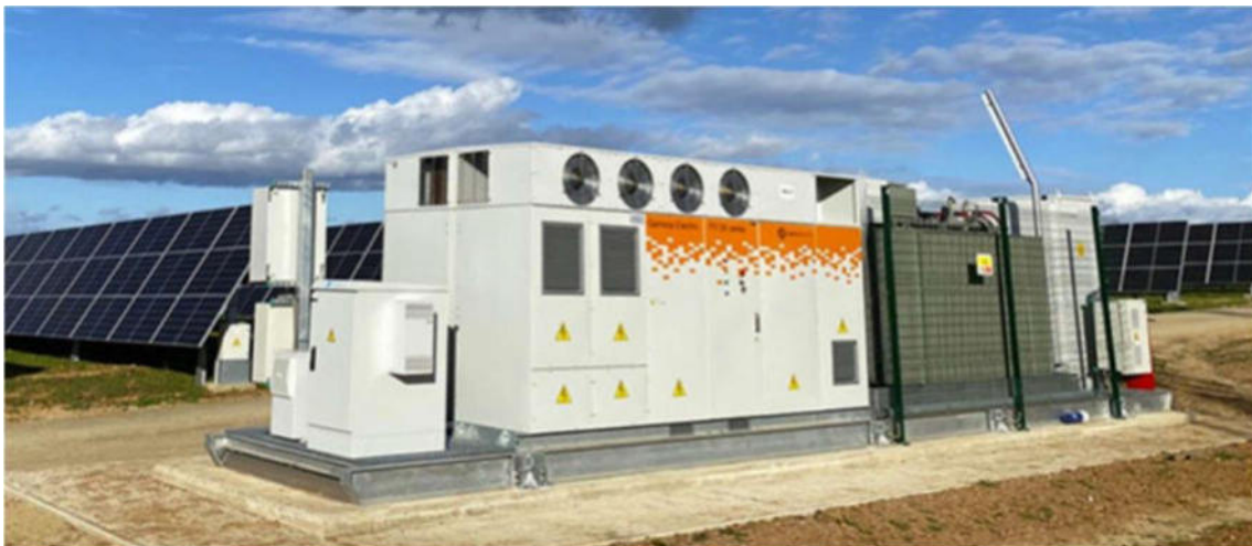
Eksempel på centralinverter med transformere. Kilde: Unison Energy Partners
