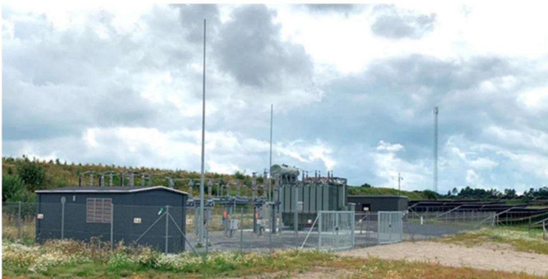
Eksempel på step-up transformer. Step-up transformeren placeres inden for en transformerstation, der er særskilt indhegnet. De to høje master inden for indhegningen er lynafledere. Kilde: Unison Energy Partners
