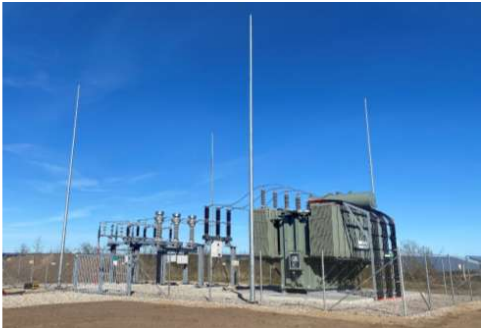
Eksempel på transformerstation med højspændingsapparater og lynafledere samt omkringliggende hegn - Solcelleanlæg ved Kolind (Foto: Urland)
