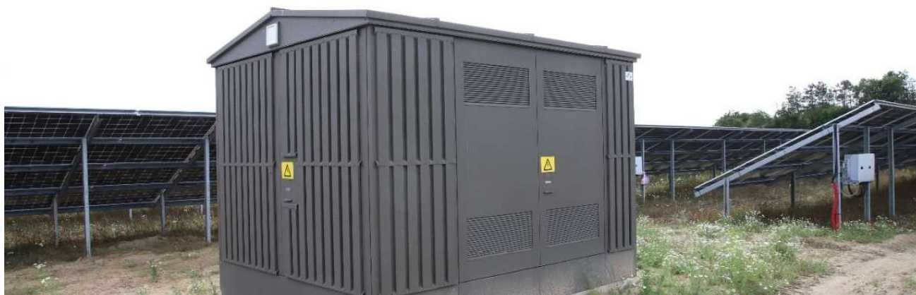
Billede 2-2: Eksempel på en 60 kV fordelingstransformer. Den hvide boks til højre er en inverter. Kilde: Unison Energy Partners
