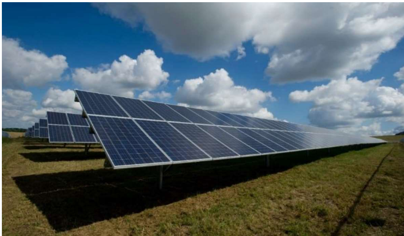
Billede 2.2: Eksempel på solpaneler placeret i fladt landskab. Kilde: Unison Energy Partners
