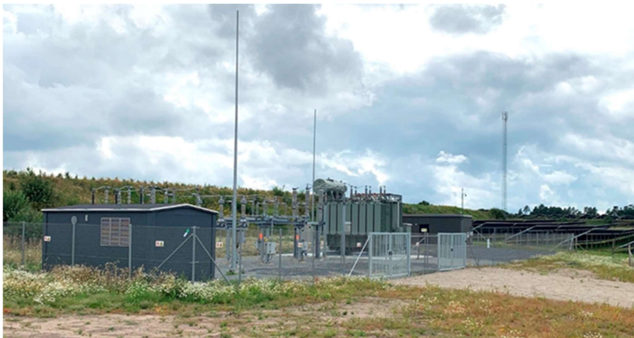
Billede 1-2: Eksempel på 60 kV transformerstation med step-up transformere. De to høje master inden for indhegningen er lynafledere. Kilde: Unison Energy Partners
