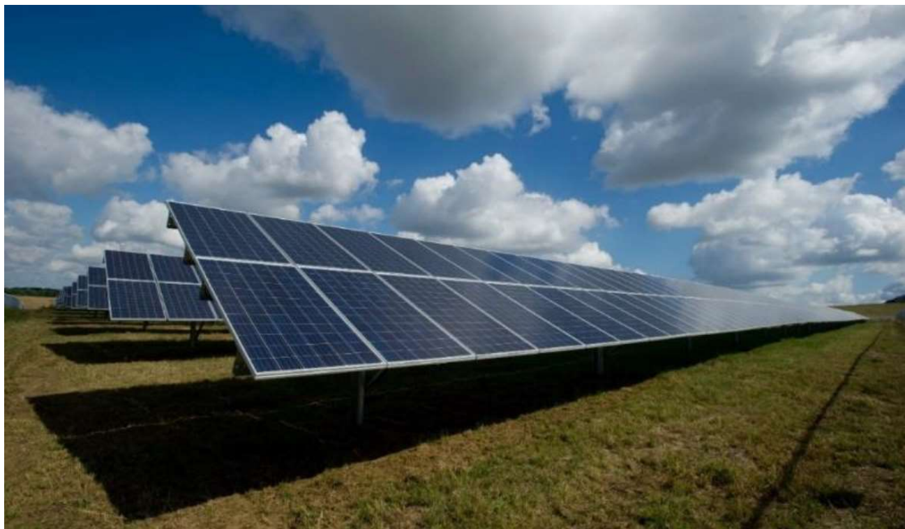
Billede 1.1: Eksempel på solpaneler placeret i fladt landskab. Kilde: Unison Energy Partners
