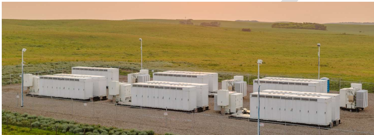
Billede 2-4: Eksempel på batterianlæg. Kilde: Unison Energy Partners
